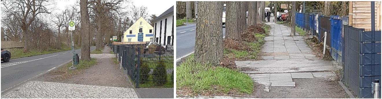
Zumutung für Fußgänger: die Gehwegsituation entlang der Potsdamer Chaussee
