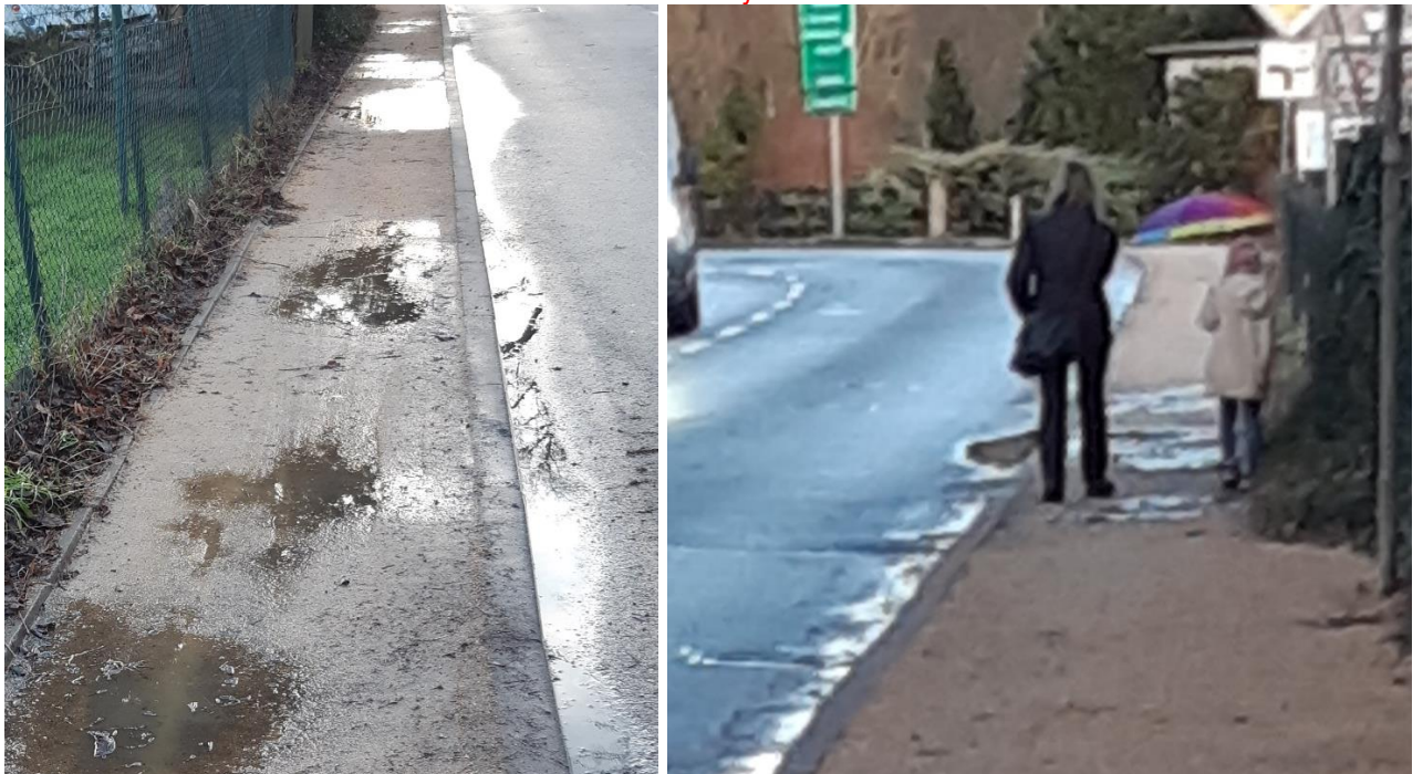
Der frisch befestigte Weg. Gerade hatte es geregnet, nicht einmal allzu kräftig: Sofort standen Pfützen auf dem Gehweg. Für Fußgänger stellte sich die Frage: Augen zu und durch oder auf die Fahrbahn ausweichen? Die Probleme sind Thema meiner nächsten Straßeninspektion mit dem Tiefbauamt.
