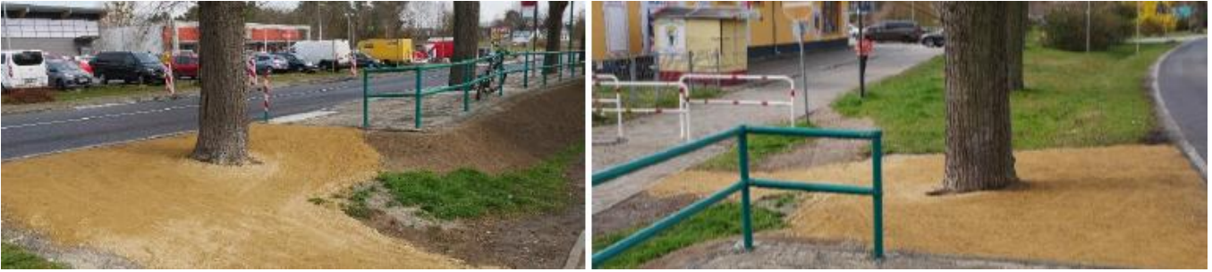
2021 hatte es große Aufregung gegeben, weil für die Bushaltestelle Theodor-Fontane-Straße kein ordentlicher Zugang gebaut wurde. Das soll nun nachgeholt werden.
